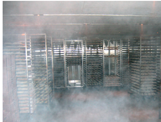
Kondensation von Warmluft in einem Kühlraum bei geöffneter Kühlraumtür
